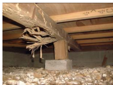
床下のシロアリ被害
