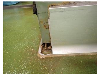
巾木の破損部
