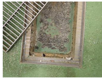
排水溝・グレーチング
