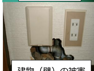
建物（壁）の被害
