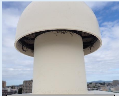
通気管防虫網の破損
