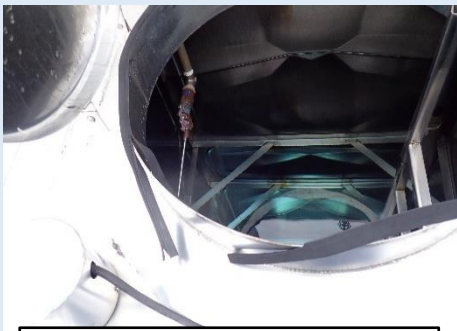
マンホールパッキンの破損
